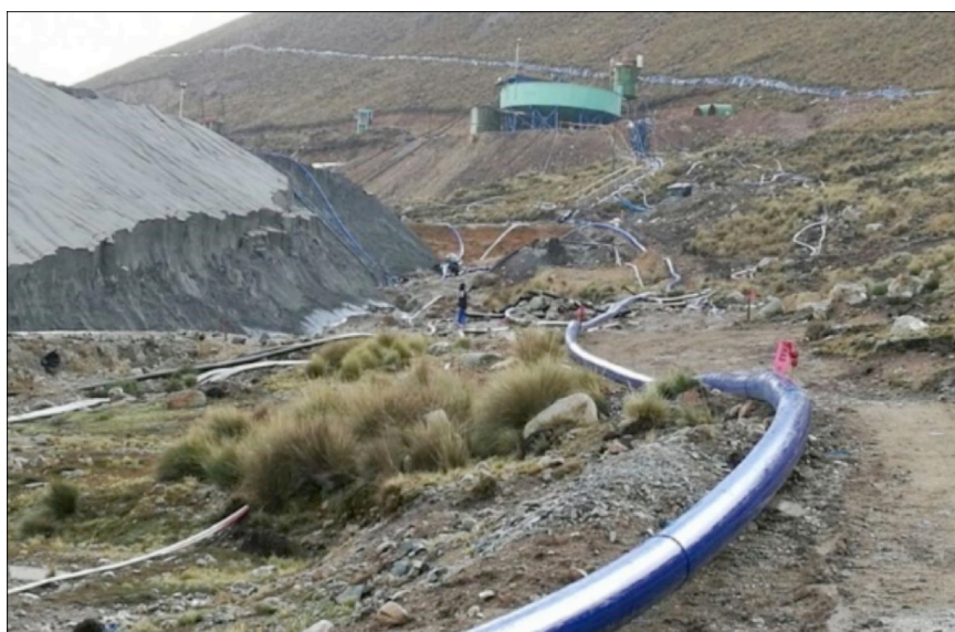
Figura 2.6 Tuberías de la compañía minera Lincuna S.A. (Perú)
