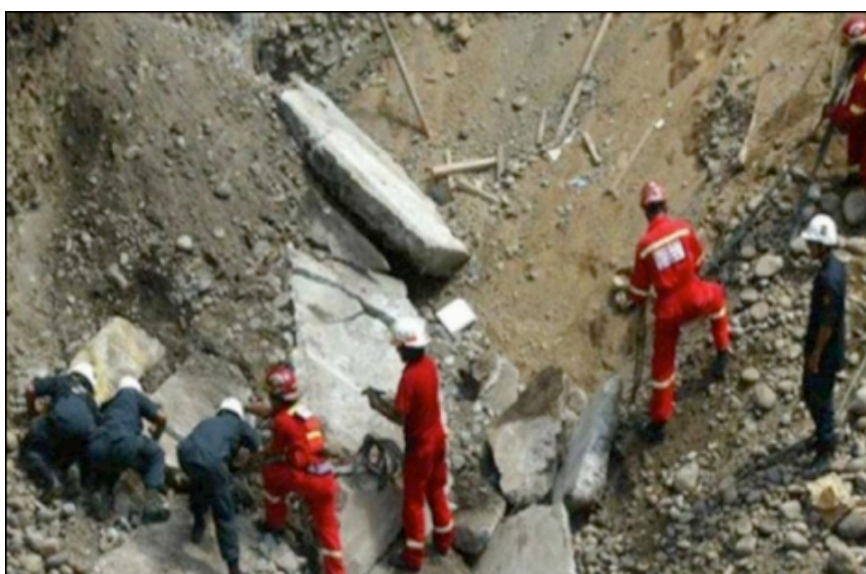
Figura 2.8 Derrumbe en mina de carbón (Perú)
