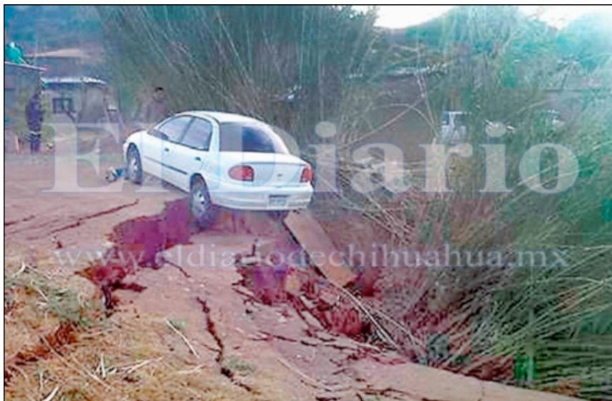
Figura 2.7 Automóvil tragado por un socavón por labores de la mina (México)
